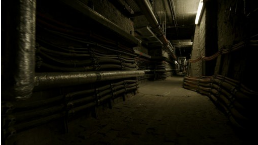
Zahllose unterirdische Versorgungsgänge durchziehen den Kölner Hauptbahnhof.
